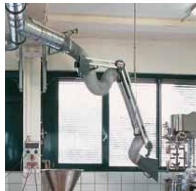
Absaugarm mit Ausleger in einem chemischen Betrieb
