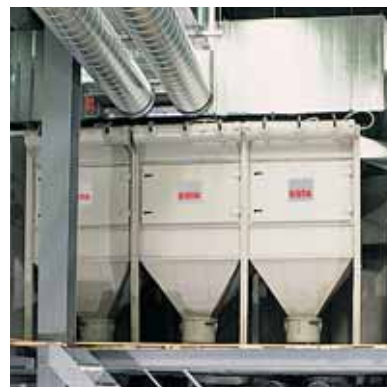
DUSTEX F – Teil einer Absauganlage
