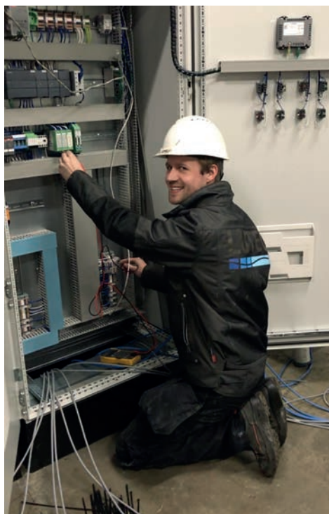
Afb. 2 De inrichting van de centrale besturingskast
